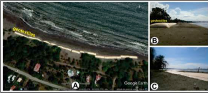
Figura 9 - Geotextiles colocados en la playa en 2017 para contener la erosión costera, posteriormente destruido por las olas de tormenta.
